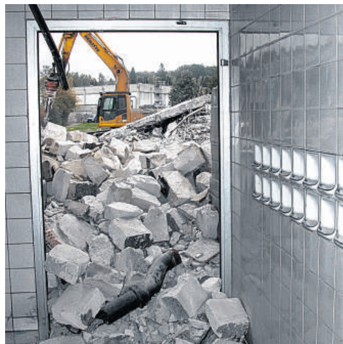
Kurios: Während in einem Duschaum eine Doppelreihe mit Seifenschalen noch heil ist, kommen von außen schon die Trümmer der Schwimmhalleendecke zur Tür hinein.
